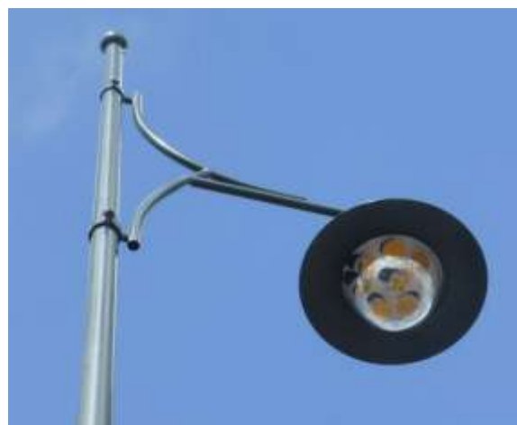
Detail van de armatuur met LED-verlichting
